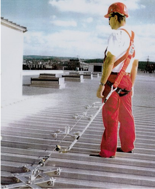
Bild 9: Beispiel für eine permanente Anschlagereinrichtung mit horizontaler Seilführung und beweglichem Anschlagpunkt
